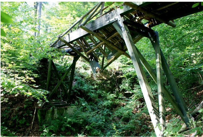
Die Teufelsbrücke nach Kyrill 2007 (Foto: F. Höchst)
