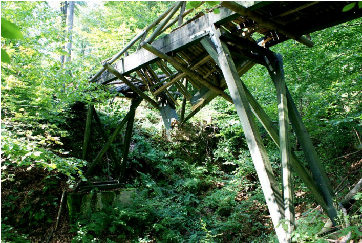
Die Teufelsbrücke nach Kyrill 2007 (Foto: F. Höchst)
